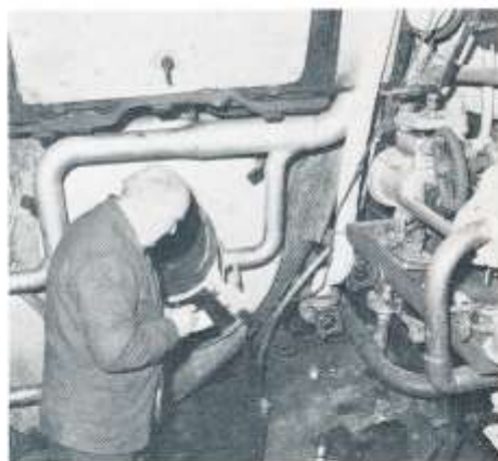
Maskinchefen Herbert Johansson på eldaredurken framför pannan. Bakom Herbert syns två av de tre eldrörsmyningarna där oljebrännarna normalt sitter. Foto Ake Karlsson 6 december 1982.
